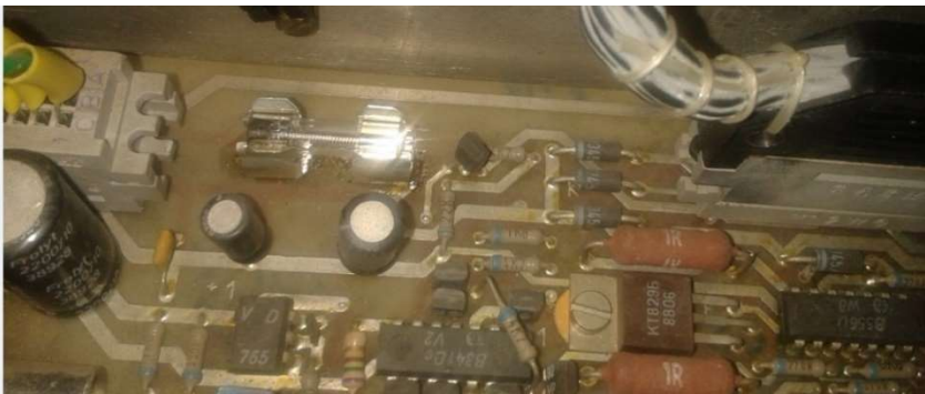
Bild 8: Neue Sicherung und Sicherungshalter
